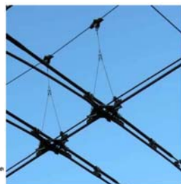
Abbildung 19. Kreuzung Obus/Straßenbahn mit Stromunterbrechung
